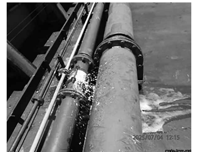
破損して水漏れする消火管
